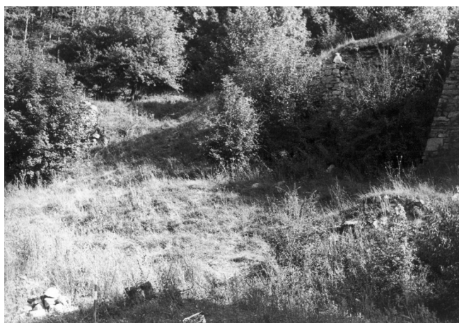
Obr. 17: Východní konec zavážecí rampy zničený působením vody vytékající z bočního žlíbku, stav v roce 1971. Archiv TMB
