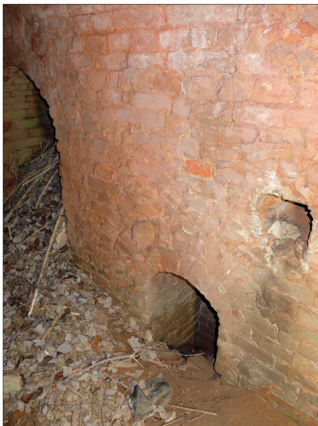
Obr. 9: Odtahový kanál kouřového sběrače. Foto: P. Holub, 2020
