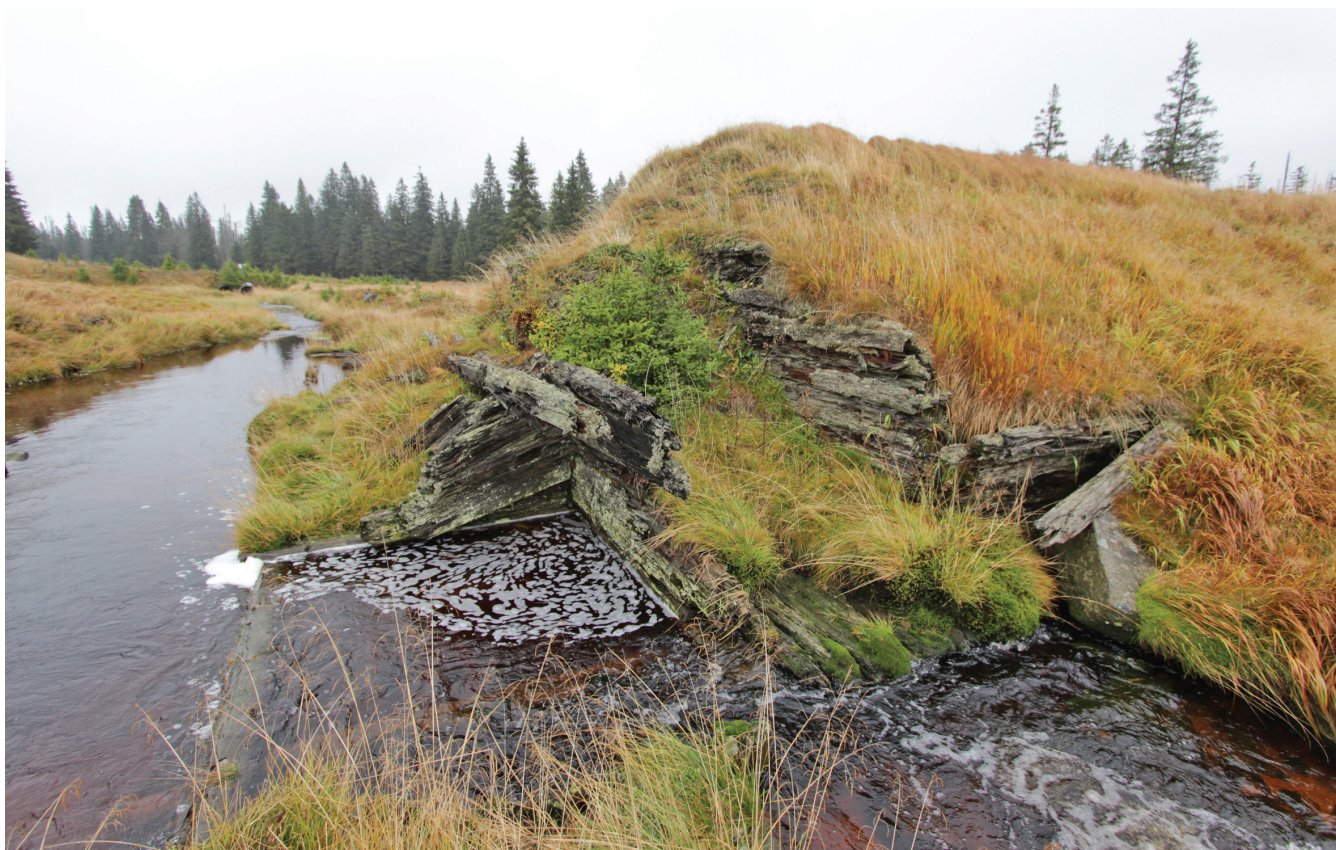
Obr. 18: Pohled na profil průlomu hráze Roklanské nádrže s dřevěnými konstrukčními prvky, pohled od JZ. Foto T. Blažková 2013
